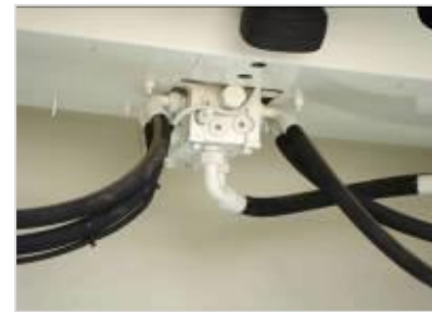
Bloque hidráulico 2 situado en tailgate
