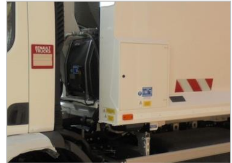
Cuadro eléctrico centralizado
