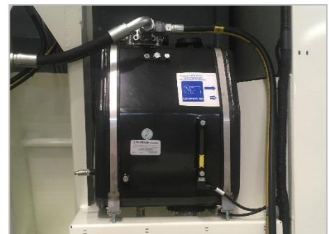
Vista frontal con el depósito de aceite
