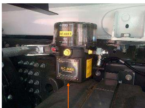
Con bomba automática
